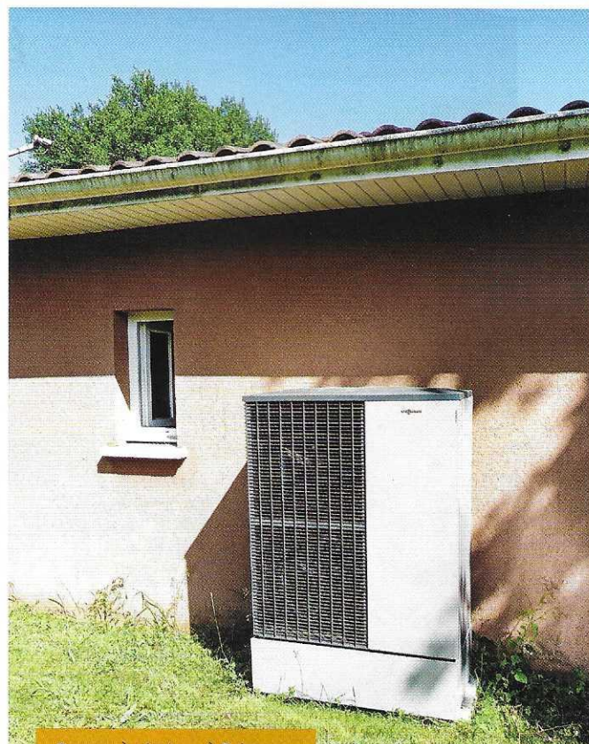
Pompe à chaleur à Tabanac
